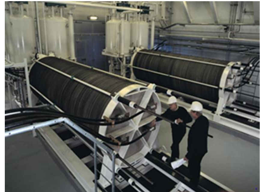
Salle des électrolyseurs, production d'hydrogène
